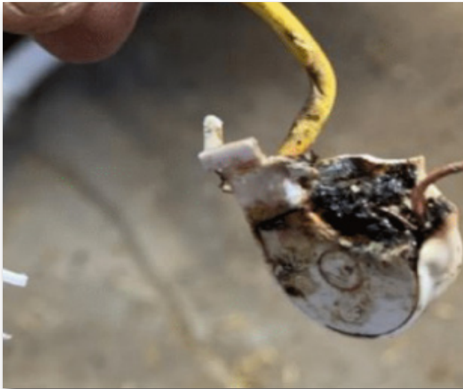
Connecteur de lumière endommagé.
