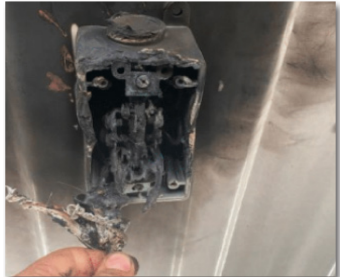
Défaut important dans une prise de courant, causé par l'humidité et la corrosion.
